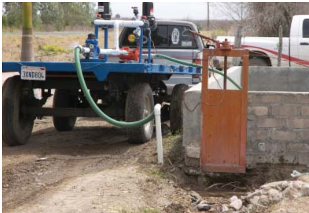
Figura 16. Equipo portátil de bombeo para la alimentación del sistema presurizado.
