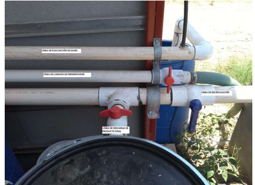
Figura. 6. Tuberías de evacuación de gases, de llenado de reactor, de recirculación y de descarga del producto final.
