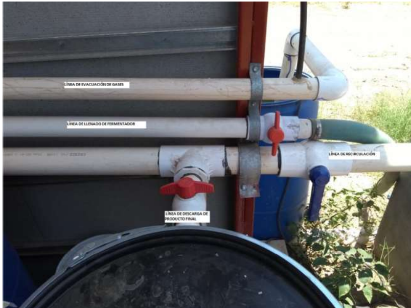
Figura. 5. Tubería de descarga de la tolva o reactor para la fermentación anaeróbica.
