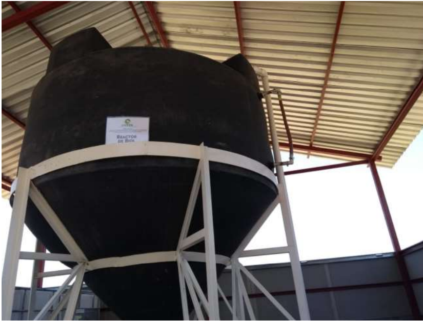
Figura. 4. Tolva o reactor para la fermentación anaeróbica.
