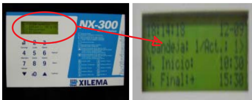
Controlador de riego, y detalle de la pantalla o display .
