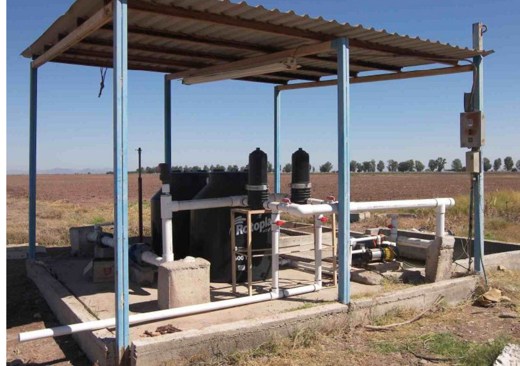
Figura 4. Sistema de riego por goteo que abastece de agua al cultivo de frijol en el CEVAF.
